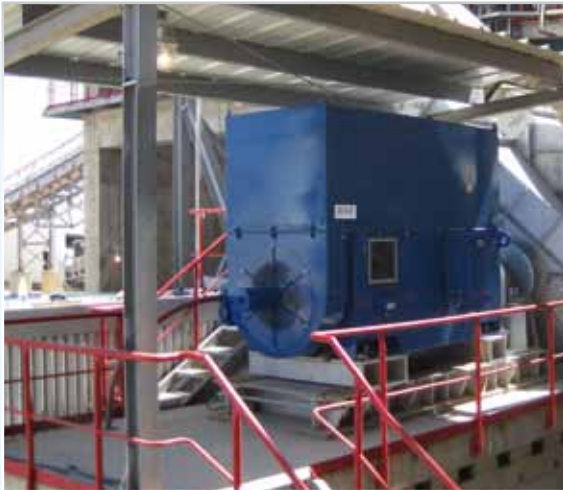
Rohmühlengebläse ASL 560-06, 1.400 KW
