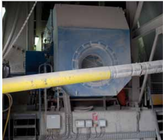
Kugelmühlenantrieb Fabrikat Converteam in UK 3.500 kW, 11.000 V, 992 rpm
