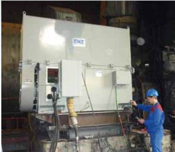
Inbetriebnahme ASL 500-04 1.800 kW, 1.485 rpm
